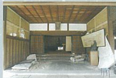
内外壁の剥落・亀裂
