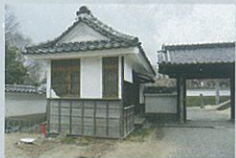
内外壁の剥落・亀裂
