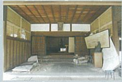
内外壁の剥落・亀裂
