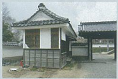
内外壁の剥落・亀裂
